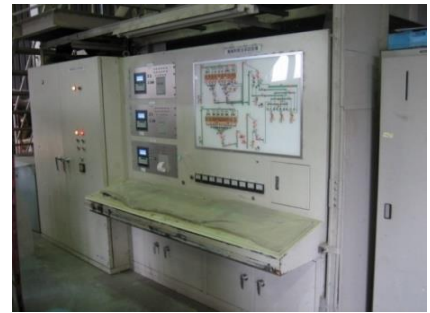
●総合コントロールパネル
