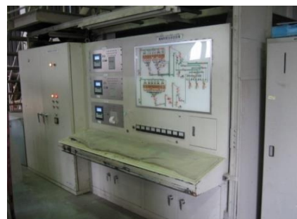
●総合コントロールパネル
