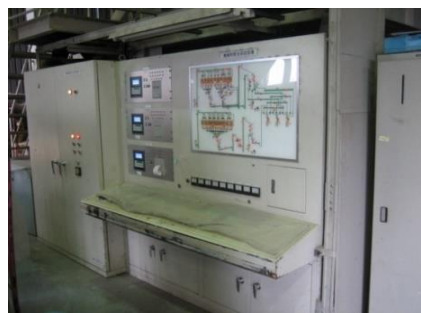
●総合コントロールパネル
